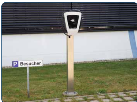
Ladesäule mit Wallbox
